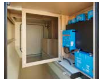
Garage mit Elektrozentrale
