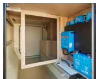
Garage con centrale elettrica
