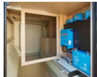
Garage med elcentral
